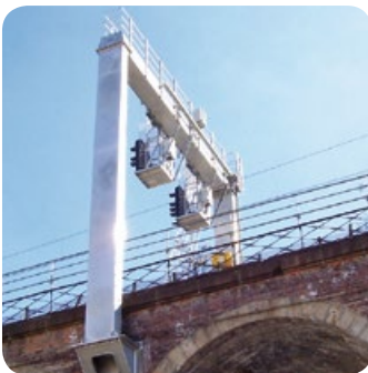
Portique porte feux SNCF sur ouvrage d'art
